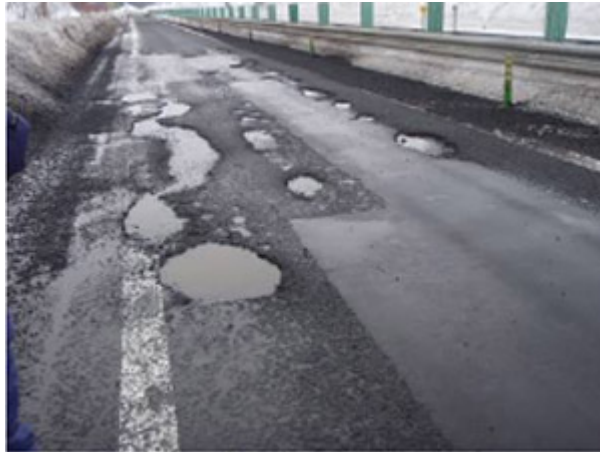
写真 2.1 ポットホールの発生事例
